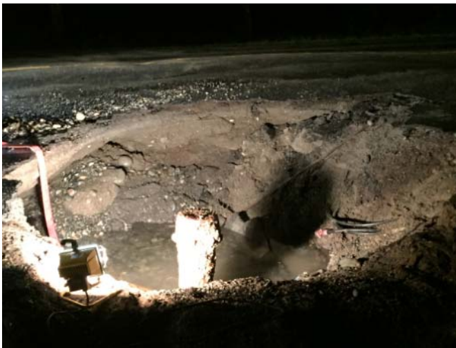
Despard Av water main break
